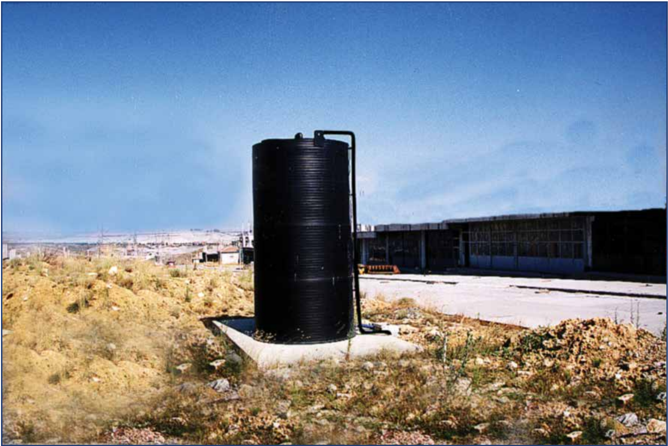
Picture 5.4 - Dizayn PE tank in use.
